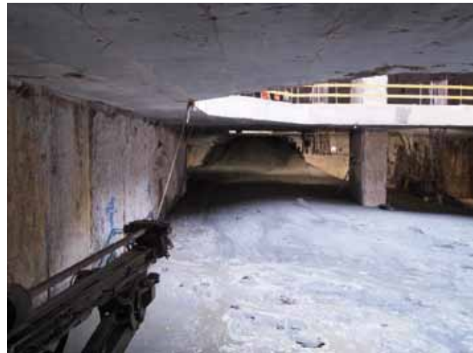
Figura 8 Afflusso di acqua, sabbia e argilla afflusso nel tunnel, e macchine nel fango
