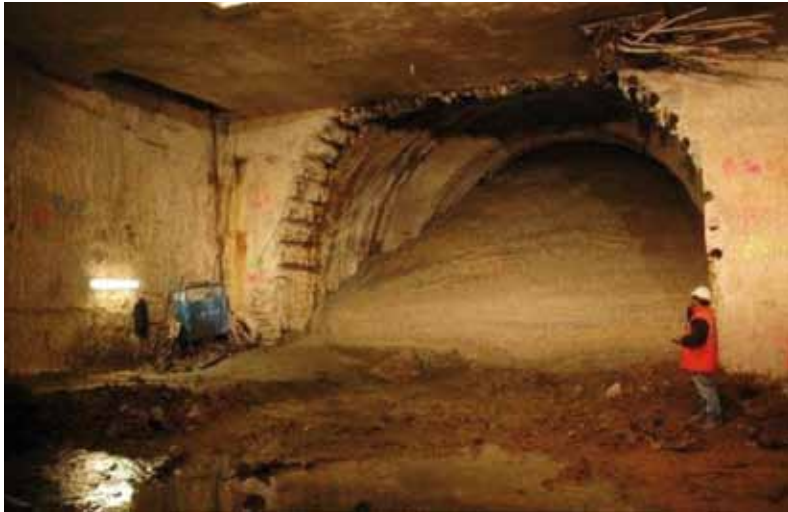
Figura 7 Collasso del fronte del tunnel
