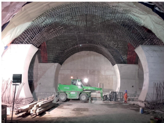
Casseratura concio di innesto tra galleria di linea e finestra (crociera) - Ferrovia Fiumetorto - Ogliastrillo (Cefalù PA).
