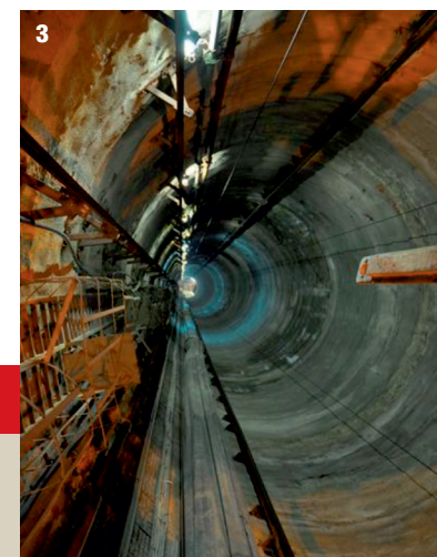
3. Cavidotto Terna: pozzo di 300 m che consente di portare i cavi alla stazione elettrica (630 m slm) 3. Terna Cable ducts: shaft of 300m, which brings the cables to the Electric Station (630m above sea level)
