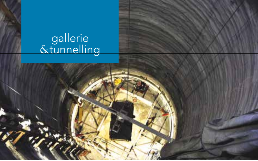
4. La piattaforma di lavoro durante la fase di scavo del pozzo verticale Melia
