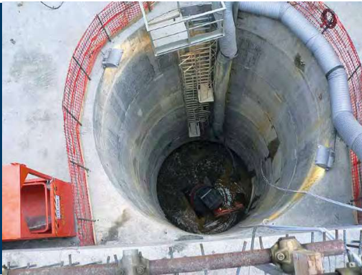
□ Excavation du puits en présence d'eau □ Shaft excavation in presence of water
