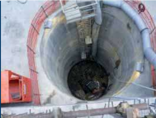
□ Scavo pozzo in presenza di acqua □ Shaft excavation in presence of water
