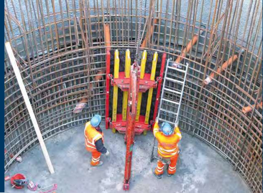
Revêtement de puits structuraux Variante di Valico Lining of structural shafts, Variante di Valico
